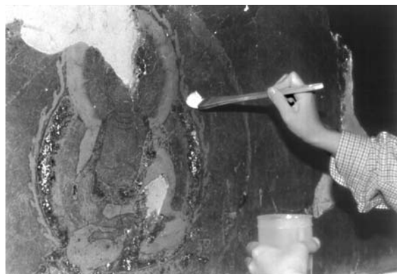
阿弥陀堂内陣の壁画は表面の彩色層や絵の描かれている漆喰層に損傷が発生し、修理が必要とされていた
