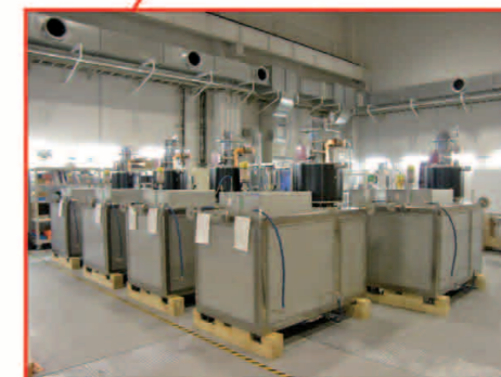
クライストロンと高電圧電源とは、テストスタンド室にて組み立てられ、動作試験を経たのち設置される。
